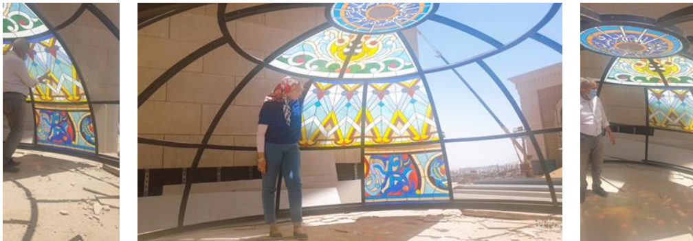
شكل ( ٢٨ ) يوضح تجربة الفص الأولي من الزجاج المعشق على القطاعات الانشائية المعدنية الخاصة بالقبة
